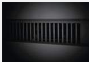
Ouvertures de ventilation
